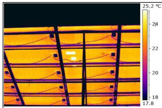
Obr. 37 Vadný sektor fotovoltaického panelu [2]
