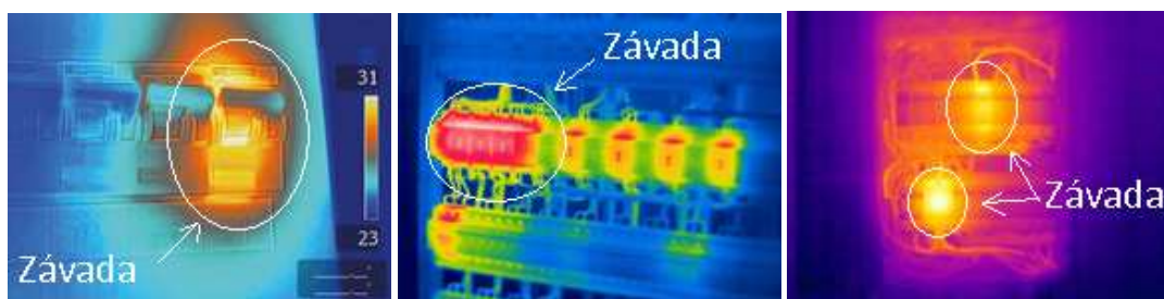
Obr. 30 Nadměrné zahřívání jisticích prvků elektrického rozvaděče [2]
