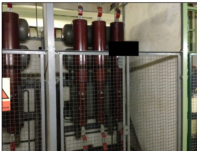
Obr. 41 Kobka spínačového prostoru rozvodny vysokého napětí
