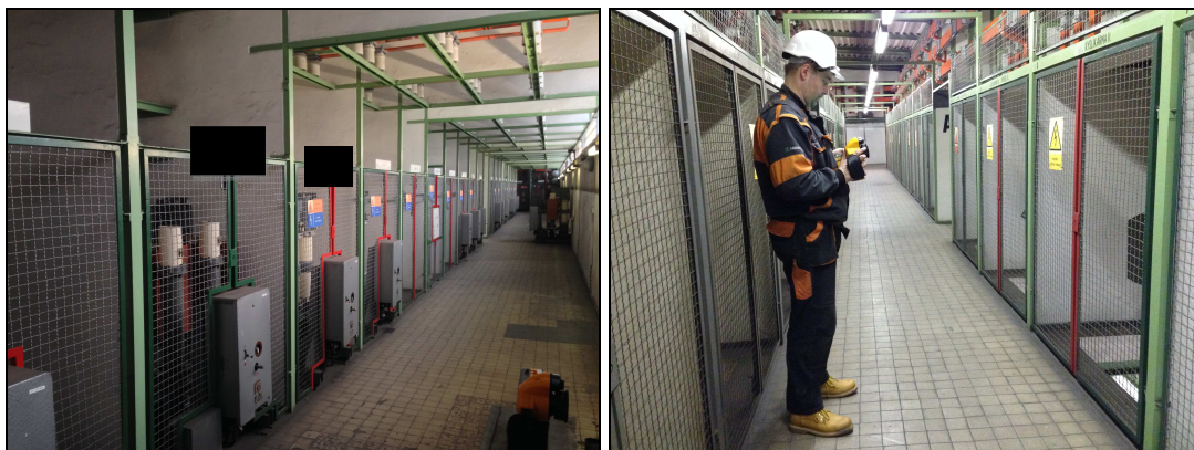
Obr. 39 Rozvodna vysokého napětí
