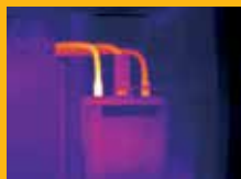
Špatná spojení a vnitřní poškození
