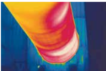
Rozlomení žáruvzdorného materiálu na rotační cementové peci
