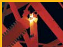
Špatně zajištěné spojení
